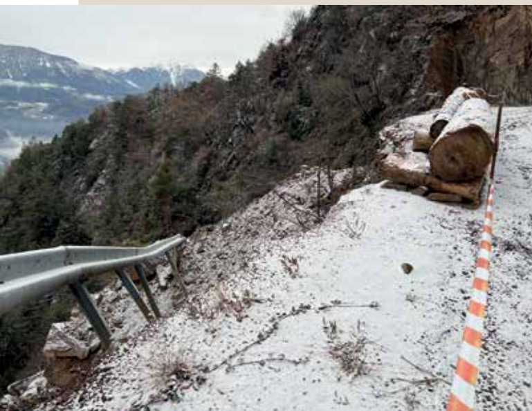
Unwetterschäden – Hangrutschung zum Reitlhof
